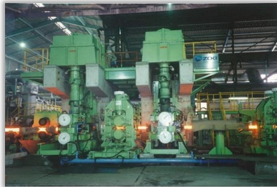
粗V-H圧延設備
